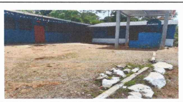
Foto 6: Se observa que el corredor no es adecuado.
